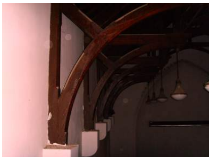
Fig. 14. Detalle de las cerchas de la capilla de Riotinto (Fotografía de los autores).
